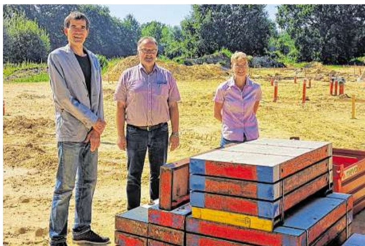
Baustellenbesuch mit Christoph vom Lehn, Diethelm Wellbrock und Mara Hopp (von links) von der Diakonischen Behindertenhilfe.
